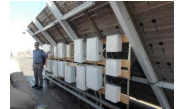
裏側に設置されているジャンクションボックス
