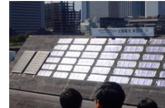
設置されているモジュール（近景）
