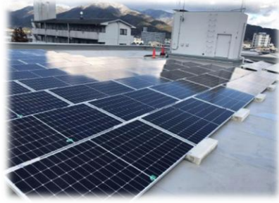
上下水道部庁舎でのPPA事業
